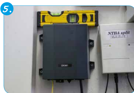
Die einzelnen Glasfasern werden fachmännisch im Glasfaserverteiler installiert. Von hier aus werden Ihre Geräte mit Glasfaser angeschlossen.
